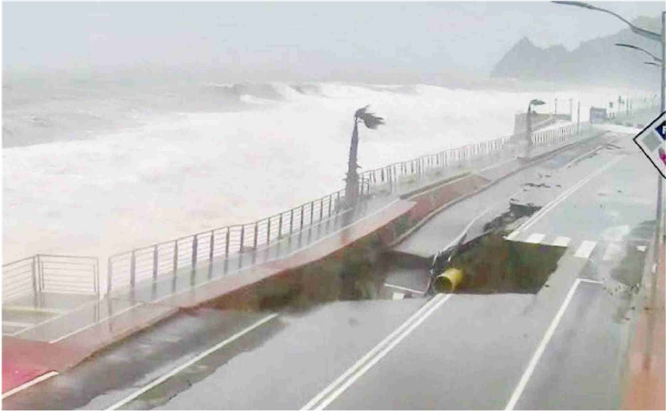
Un evento distruttivo Il lungomare di S. Teresa di Riva
