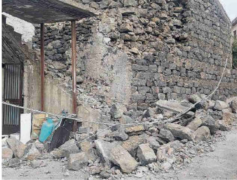
Una delle abitazioni di Ragalna danneggiate dalla scossa di terremoto
