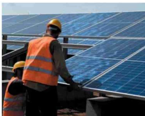
Fuori dal beneficio i moduli fotovoltaici
