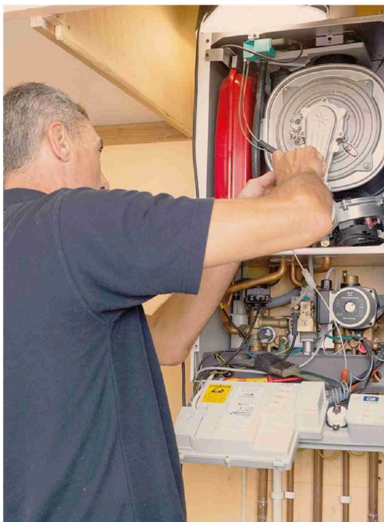
La soglia. La bozza di regolamento prevede oggi requisiti irraggiungibili per le caldaie
