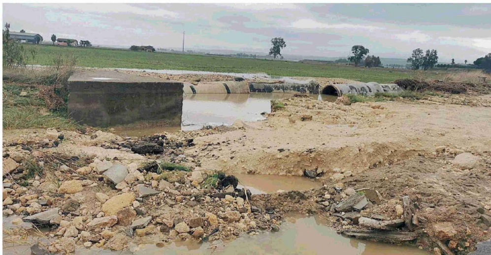
Le tubazioni irrigue di Magazzinazzo danneggiate di recente. Gli utenti chiedono il ripristino del canale
