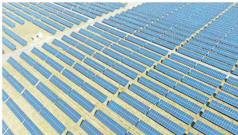
▲ L'impianto Una distesa di pannelli fotovoltaici
