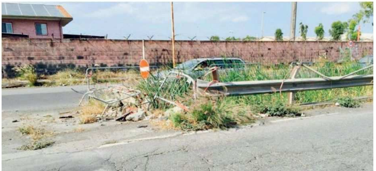
L'ASPETTO ATTUALE DELLA ZONA INDUSTRIALE IN UNA FOTO CHE RITRAE UNO SCORCIO FRA ALCUNE STRADE: MARCIAPIEDI DIVELTI, SEGNALETICA ARRUGGINITA, VERDE INCOLTO ED ESUBERANTE, BUCHE COME VORAGINI, DEGRADO STRUTTURALE
